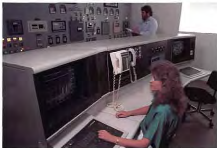
MG Industries erweitert erheblich die Produktionskapazität von Industriegasen. Der Luftzerlegungsprozess wird z. B. in der Anlage (Auszug) von Tarragona (spanisch) zentralisiert gesteuert und überwacht.
